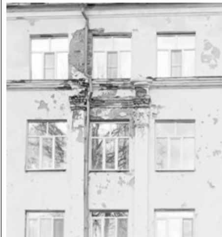
Школа №29: разрушенный фасад
